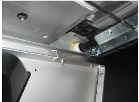
Rouleau de guidage à l'extrémité de la rampe
