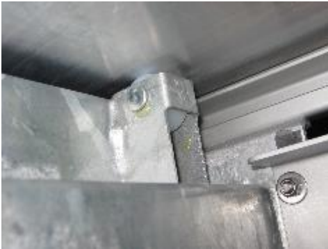
Rouleau d'appui à l'arrière et une partie de la surface d'appui latérale sur le garde-corps sous la rampe d'accès au bateau
